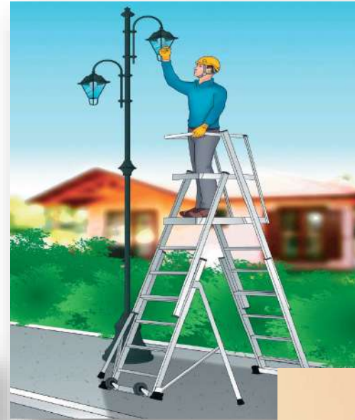
scala mobile con piattaforma
